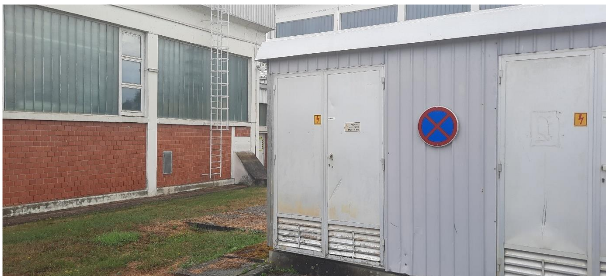
Slika 3-1. Postojeća trafostanica na lokaciji zahvata Izvor: HiPP Croatia d.o.o.
